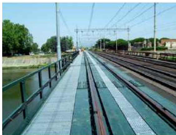
Figura 4. Vista del ponte sull'Arno tra le Stazione di Pisa Centrale e Pisa S.Rossore [25]
