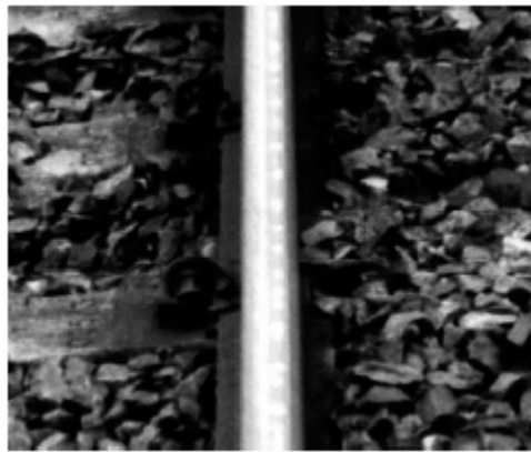
Figura 1. Evidente corrugamento della rotaia.
